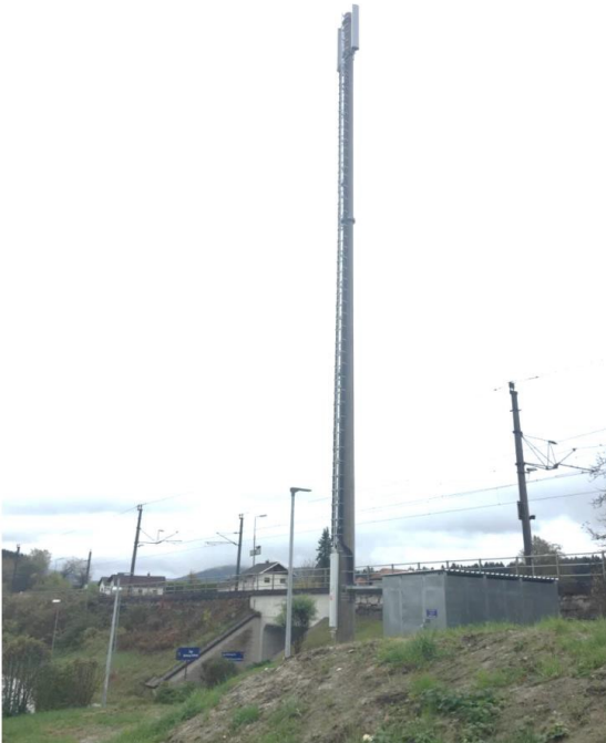
Abbildung Darstellung Funkmast (Masthöhe 32 m) und Schalthaus (Größe 3,4 m * 5,4 m)
