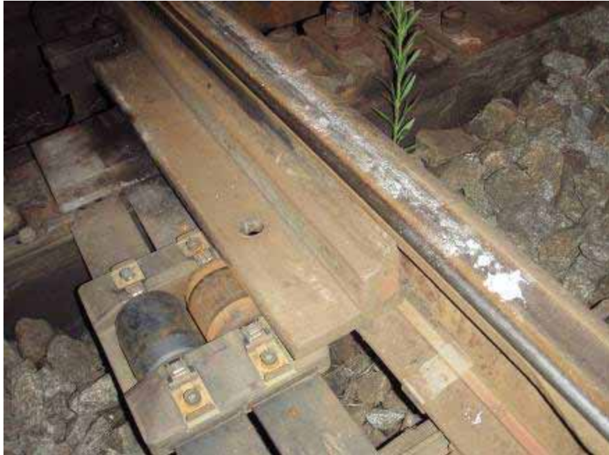
Abb. 11 Rechter Schienstrang der Weiche 2 nach Entfernen des entgleisten TW
