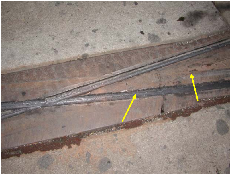
Entgleisungsspuren beim Herzstück der Weiche 62 im Bereich der Straßenkreuzung Edelsinnstraße/Philadelphiabrücke (WLB Richtung Baden – Wiener Linien, Linie 62 Richtung Wolkersbergenstraße)
