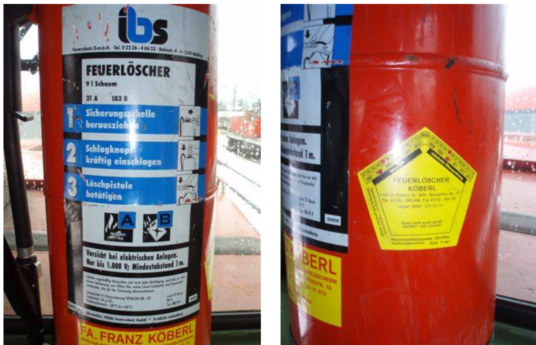
Abbildung 6 Im Führerraum des Tzf vorgehaltener Handfeuerlöscher
