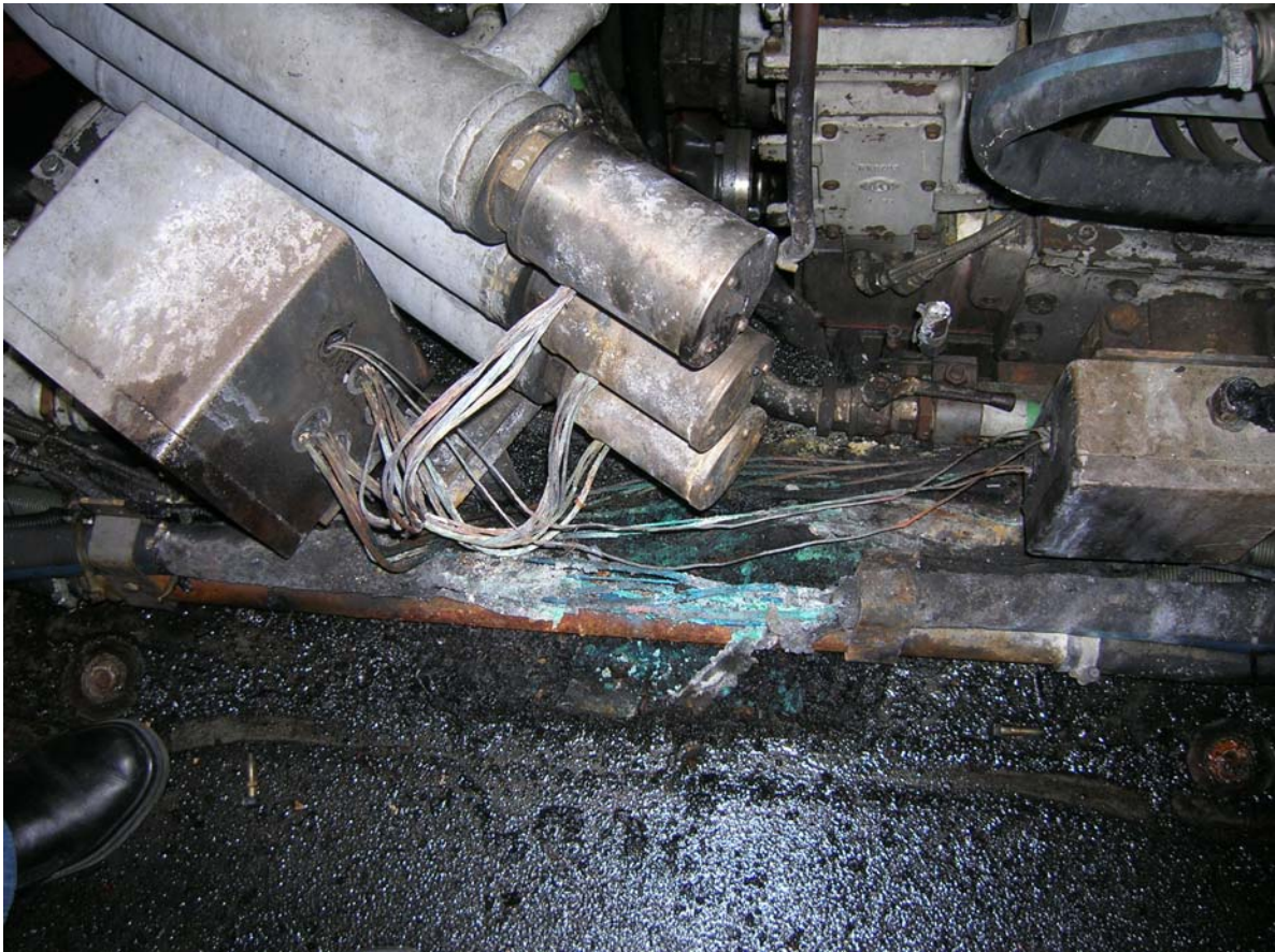
Abbildung 13 Ansicht Kabelbaum der Motorsteuerung
