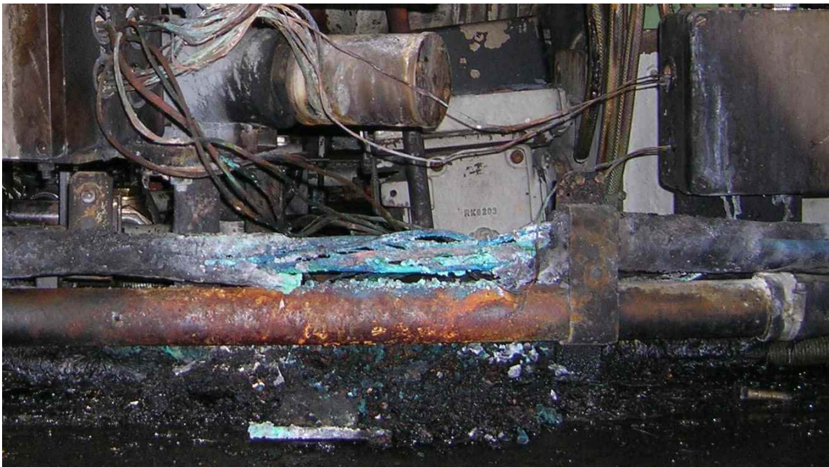
Abbildung 14 Detailansicht Kabelbaum der Motorsteuerung
