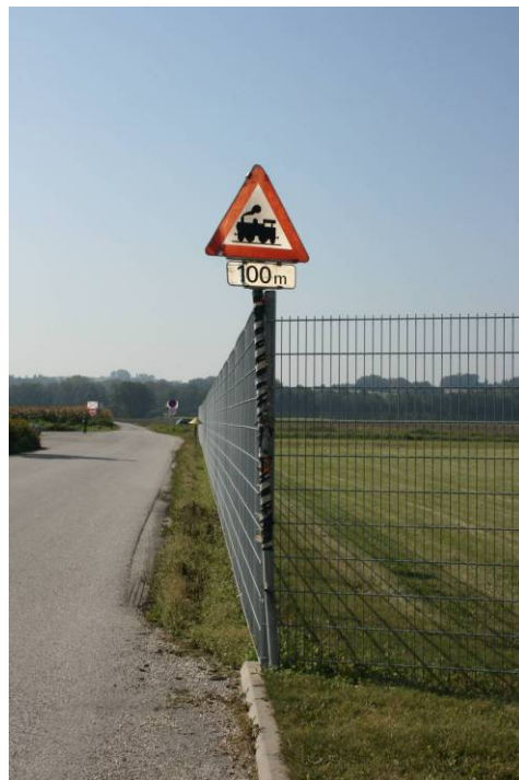
Abbildung 6 Verdecktes und beschädigtes Verkehrszeichen (Quelle: UUB)
